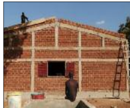
Die Aktion „BauSTEIN aus KufSTEIN“ des Arbeitskreises Weltkirche der Pfarre St. Vitus trägt viel dazu bei, dass der Bau des Gemeindehauses rasch voranschreitet.
